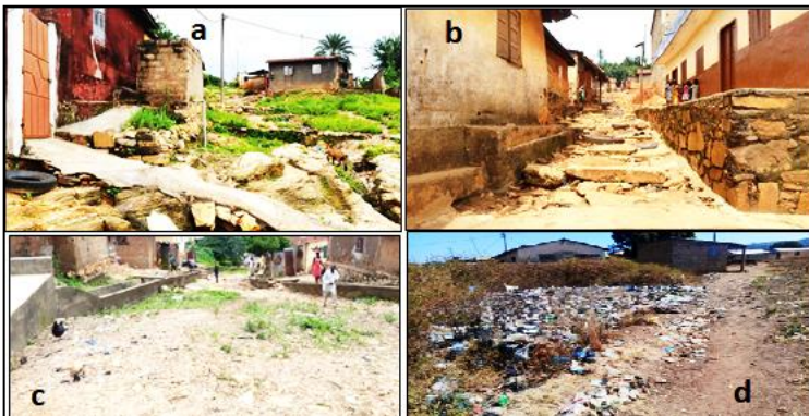
Planche 1 : Etat dégradé des voies de desserte dans la ville de Bafilo
