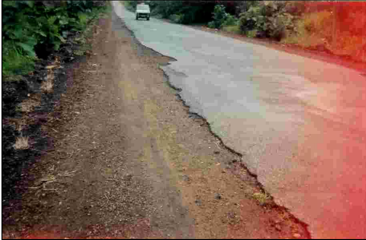
Photo 1. L'état de la route internationale Lomé-Cinkassé Prise de vue : Vimenyo, 2009.
